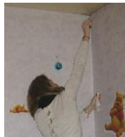
Prélèvement par écouvillon de moisissures visibles
