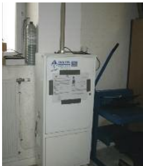
Surveillance au lycée de Crézancy (02) en air intérieur
