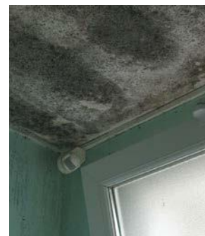
Moisissures visibles dans un logement humide
