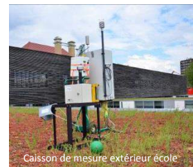
Caisson de mesure extérieur école
