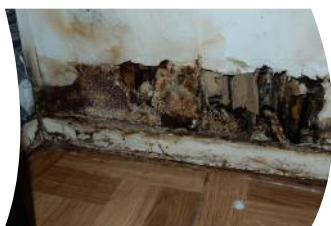
Moisissures dans un logement
