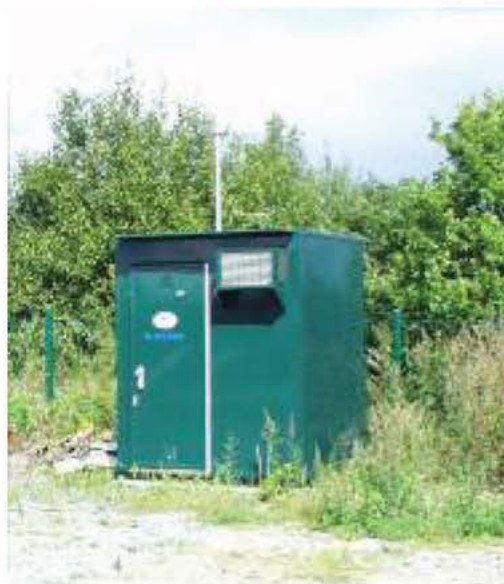
Station de mesure d'Hirson
