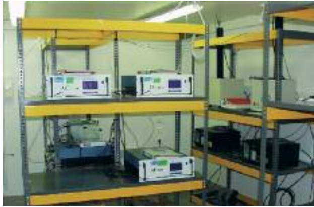
Intérieur de la station de mesure de Creil «La Faïencerie»
