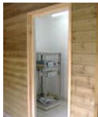
Aménagement de la station ozone de Saint-Gobain
