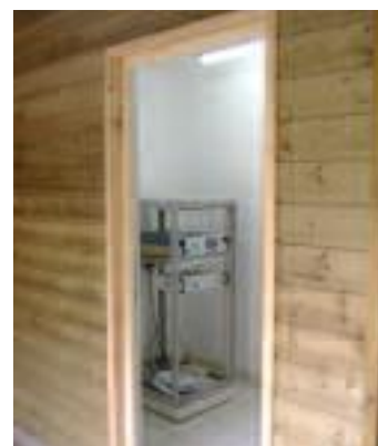
Aménagement de la station ozone de Saint-Gobain
