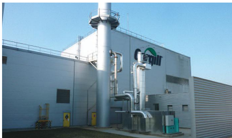
Système de traitement des fumées et des odeurs
