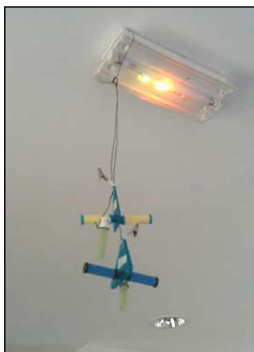
Figure 5 : Tubes passifs aldéhydes, COV et NO 2 posés en doublon (Géodomia)
