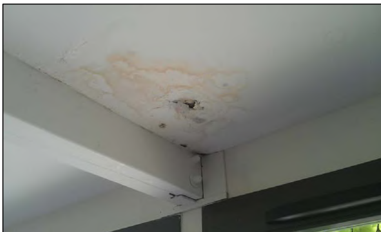
Figure 22 : Moisissures constatées à Géodomia
