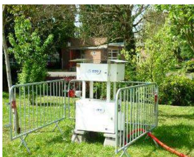
Installation du préleveur sur le site de Lille Fives
