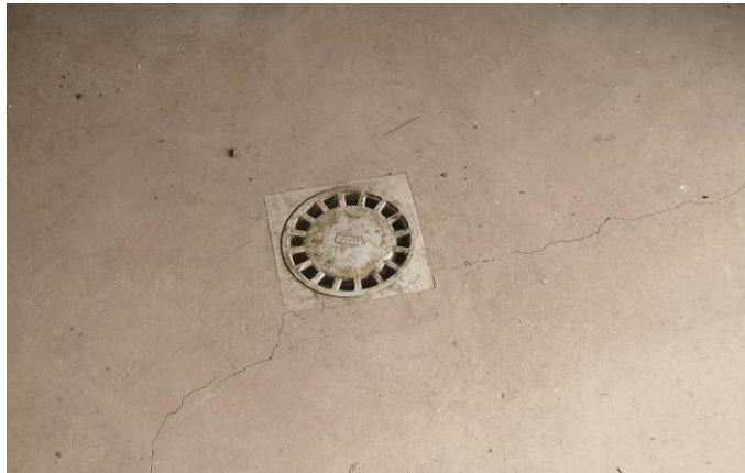
Siphon de sol chaufferie
