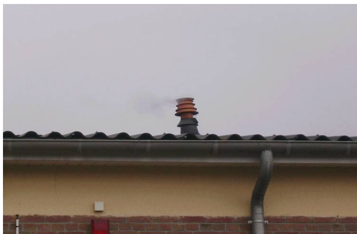
Évacuation des gaz brulés en toiture
