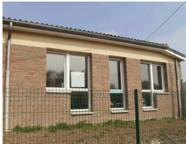
Façade orientée sud sans protection solaire
