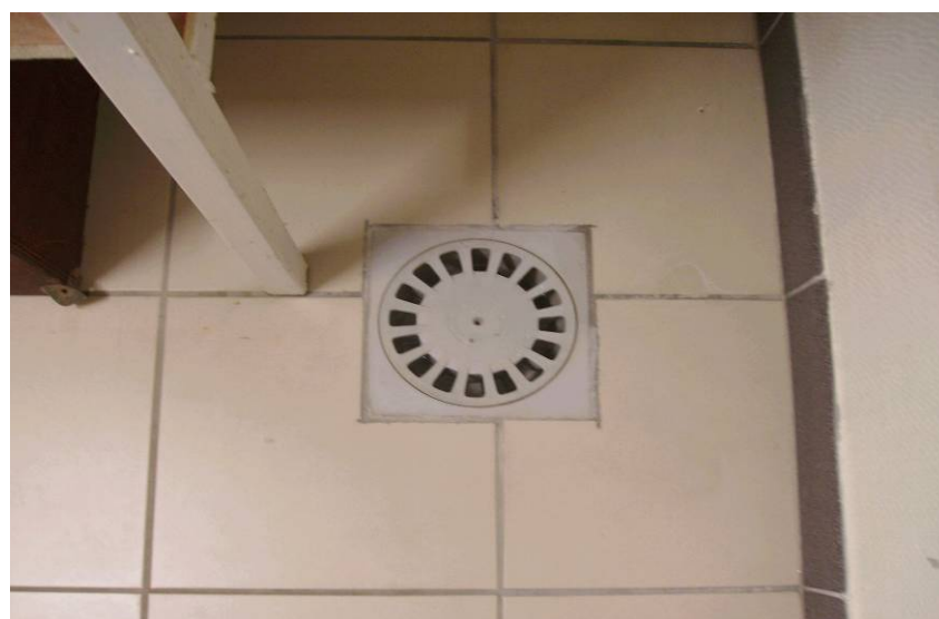
Siphon de sol salle stockage des produits d'entretien
