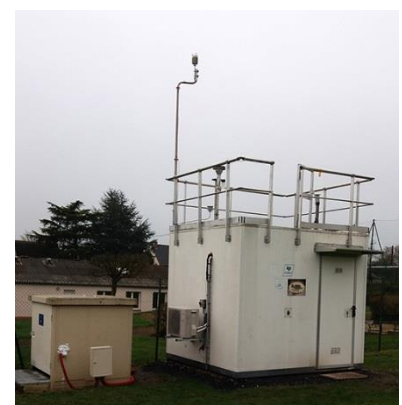
Station de mesures installée à Caillouël-Crépigny
