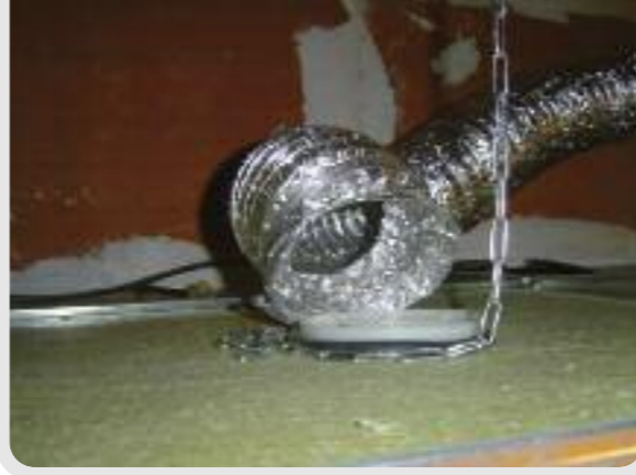
Photo 12 : Bouche déconnectée au-dessus du plafond
