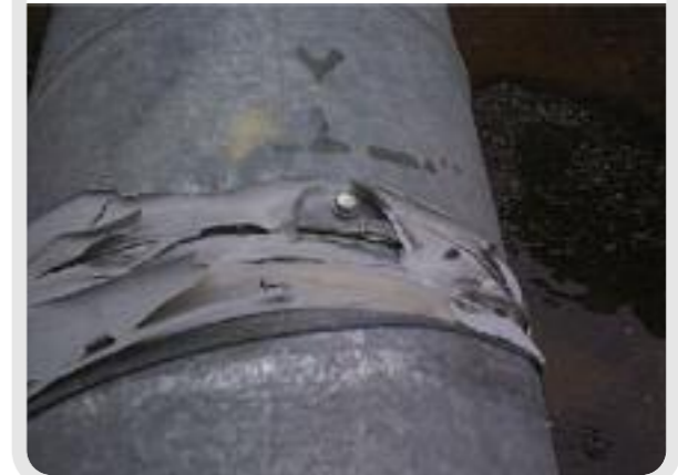
Photo 6 : Adhésifs détériorés sur conduits extérieurs
