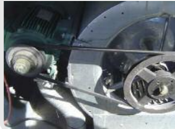
Photo 2 : Courroie ventilateur en bon état
