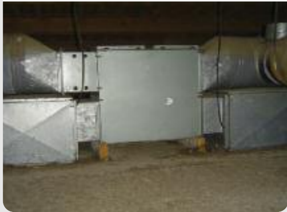
Photo 1 : Centrale double flux dans des combles
