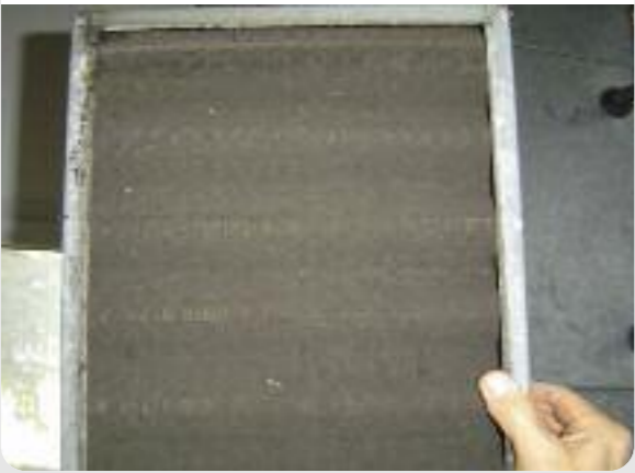
Photo 15 : Filtre de CTA très encrassé
