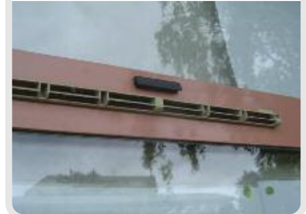
Photo 8 : Entrée d'air dans une fenêtre
