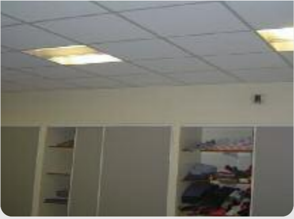
Photo 13 : Bouches d'extraction d'air dans un dortoir
