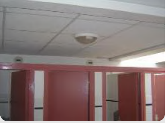
Photo 11 : Bouches d'extraction dans des sanitaires
