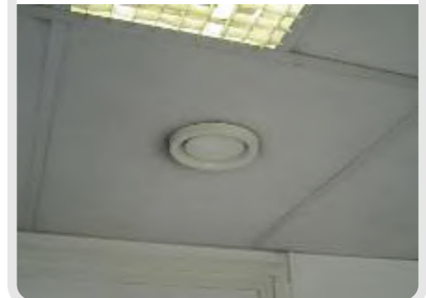
Photo 10 : Bouche de soufflage d'air dans une cantine
