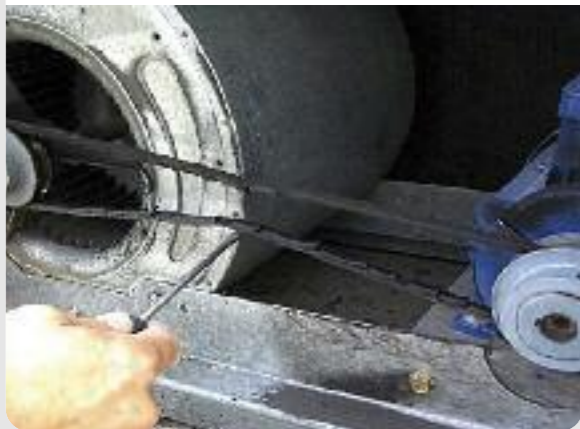
Photo 3 : Courroie ventilateur en mauvais état
