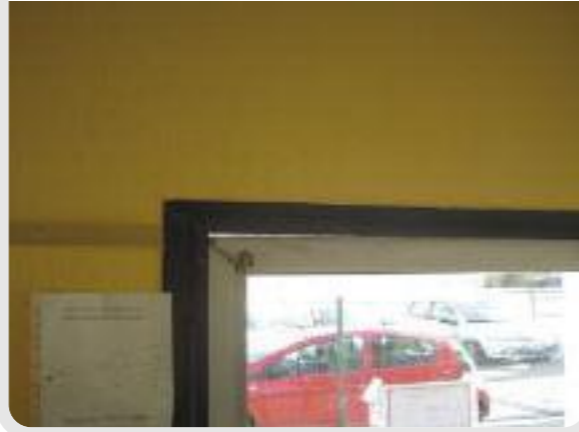
Photo 14 : Porte-fenêtre non étanche à l'air (jour visible)
