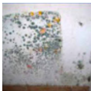
Contaminations fongiques sur un mur
