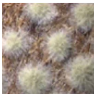
Développement de moisissures grandissement x50
