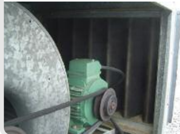
Photo 4 : Intérieur CTA avec filtre à air
